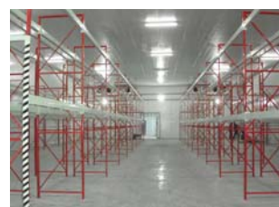
Холодильник 1000 т, УзловаяРыба, Тула
